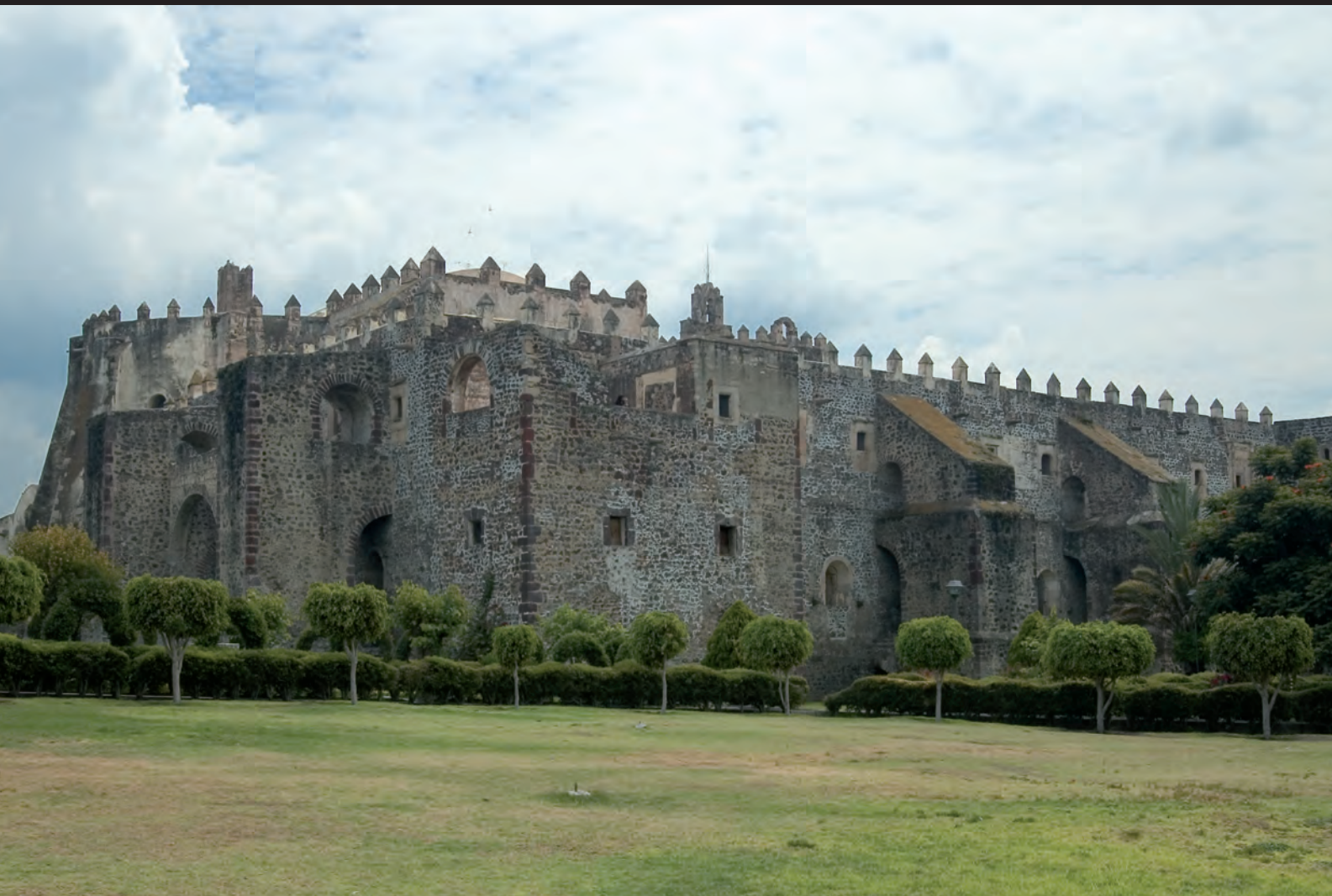
▲ Contrafuertes del lado norte del ex convento de Yuriria (fotografía: Eumelia Hernández)
