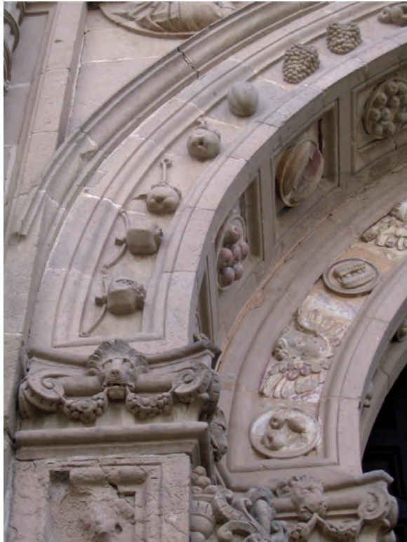
▲ Detalle de la arquivuelta del arco en la portada principal de la iglesia de Acolman (fotografía: Eumelia Hernández)
