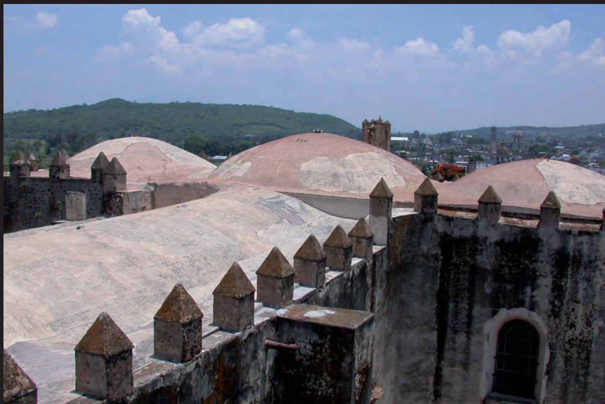
▲ Junta constructiva del crucero con la nave del templo. Vista desde la azotea (fotografía: Elsa Arroyo)
